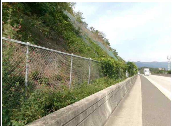
야생동물유도울타리, 도로부 전경
